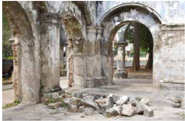
写真 17. 崩落した壁の一部
