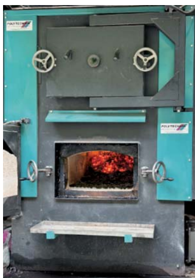
図6 木質チップボイラー
